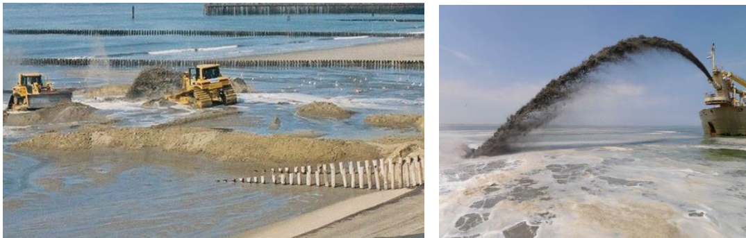
Figuur 4 Foto's van de aanleg van een strandsuppletie (links) en het opsputten, of rainbowed, van een vooroeversuppletie (rechts). Bron: natuurlijkveilig.nl
