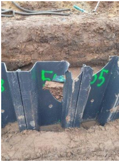
Figuur 7 Beschadiging aan de bovenzijde van de damwand
