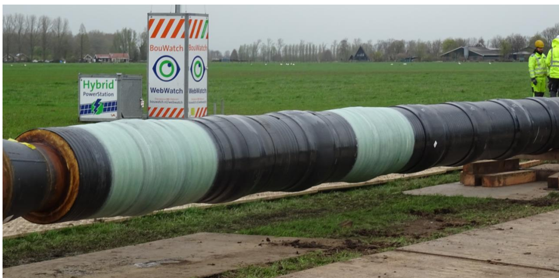
Figuur 2.10 De samengestelde 28" Staal-PUR-PE leiding, links is overgang naar segment 3 te zien (foto: Deltares).
