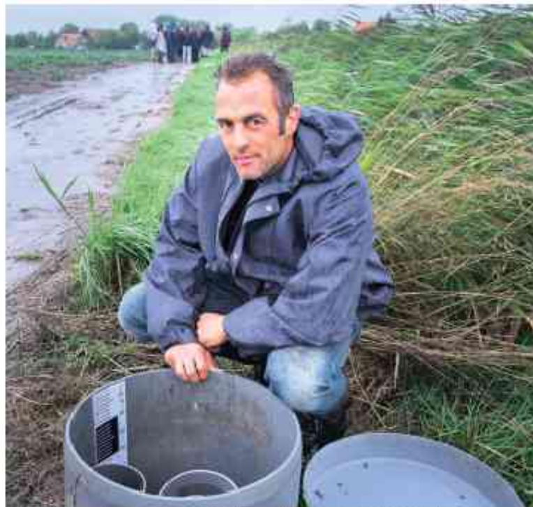
• Werner Louwerse bij een inlaat van de hoofd drainage, „Hierin regel ik het peil.” foto: Dirk Jan Gijzen
