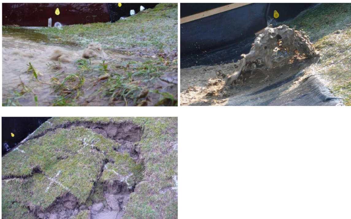
Figuur F.5 Uitspoelen van zand door een molgang onderaan het talud, gevolgd door ondermijning van de kleilaag en falen van de bekleding (Golfoverslagproef Tholen).
