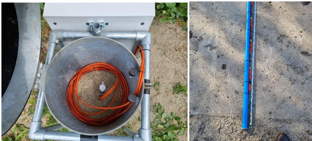
Figuur 2-4 Pilot met zoutwachterkabel in put afgewerkt (links) en elektroden op de kabel aan peilbuis (rechts).
